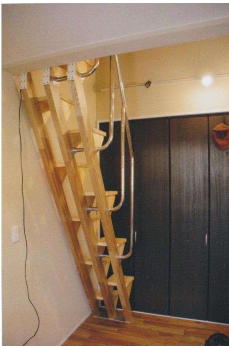
現在の取付方法の手すりです。
